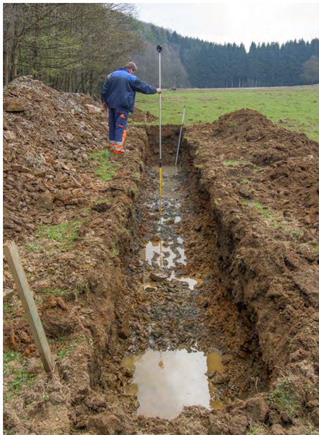
Abb. 51: Schurf zur Erkundung des Bodenaufbaus und der Höhenlage des Talkieses in der Aue der Großen Schmalenau im Rahmen des LIFE-Projektes „Bachtäler im Arnsberger Wald“
